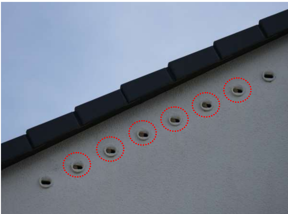
Abb. 25: Giebel Wiesenstraße 30 im Jahr 2022 mit sechs „zugemauerten“ Mauerseglerkästen.
