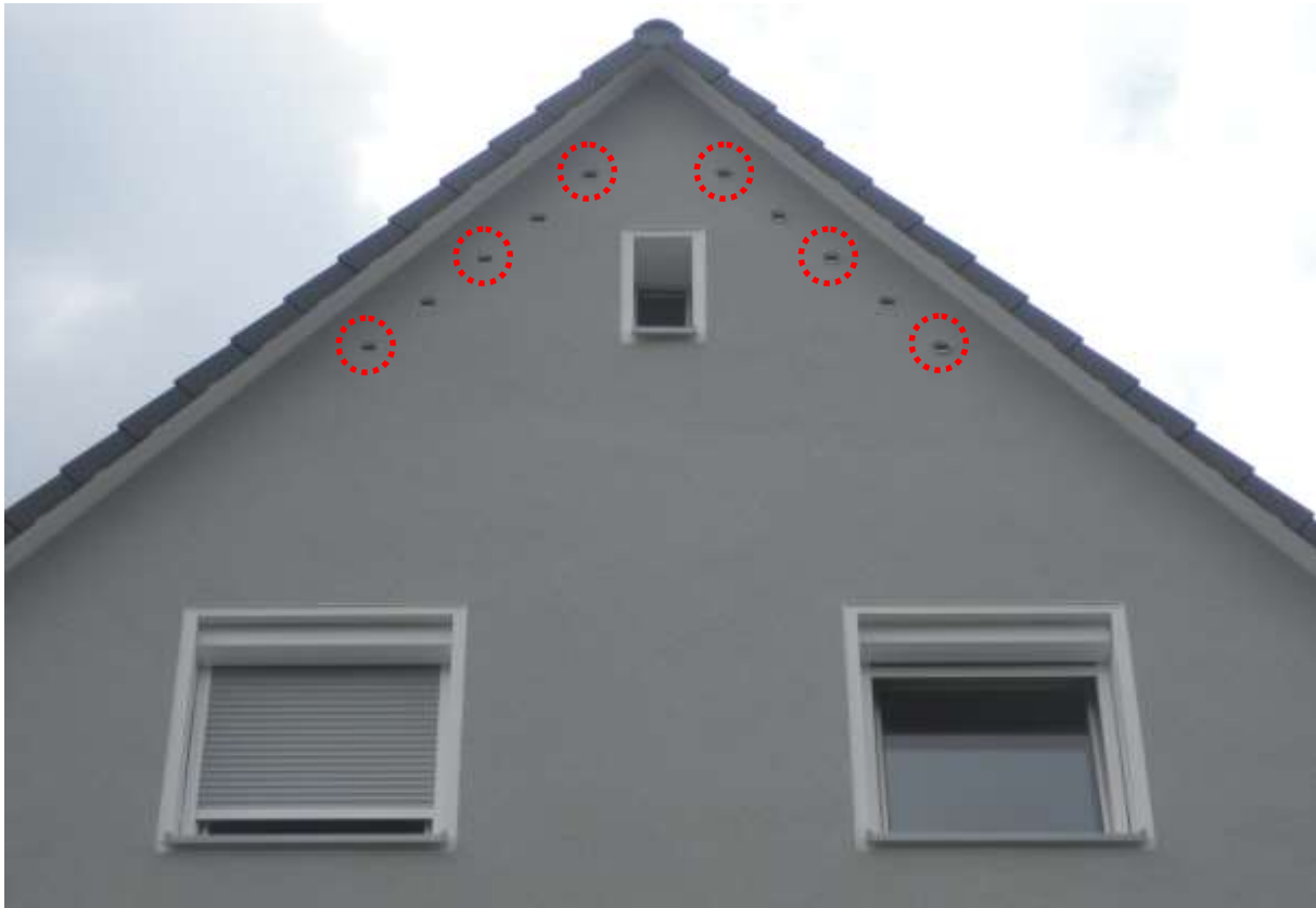
Abb. 17: Zehn fassadenintegrierte Mauerseglerkästen WDV 1A am Gebäude „Auf dem Gerre“ 27.
