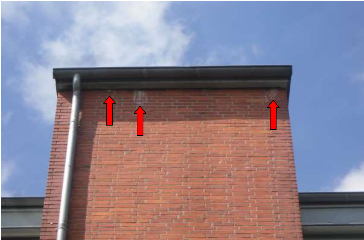
Abb. 21: Mauerseglar-Brutplätze hinter den hölzernen Traufkästen an der Fluraußenwand.
